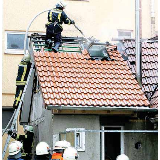
Einsatz der Feuerwehr bei einem Dachstuhlbrand.
