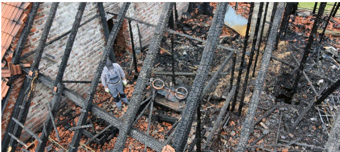
Blick auf den ausgebrannten Dachboden. In der Bildmitte ist eine Spezialleuchte für die Pflanzenaufzucht zu sehen.
