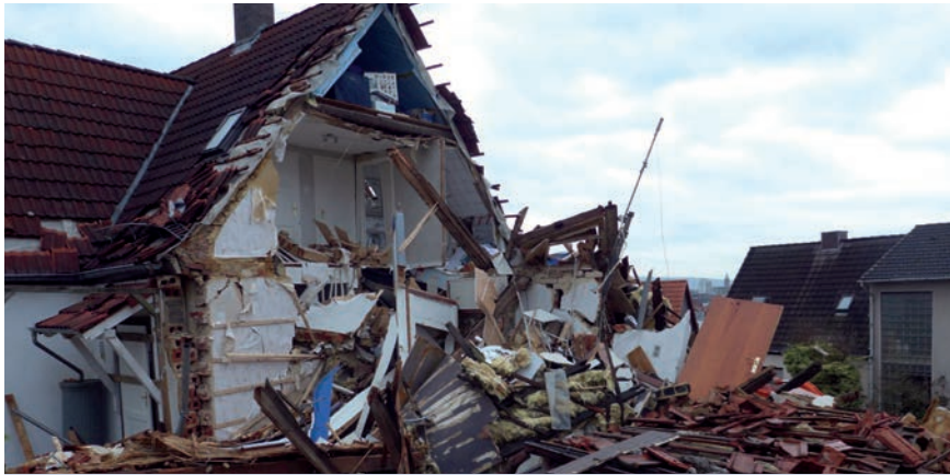
Die Doppelhaushälfte wurde zerstört, nachdem ein Gasheizgerät manipuliert wurde.
